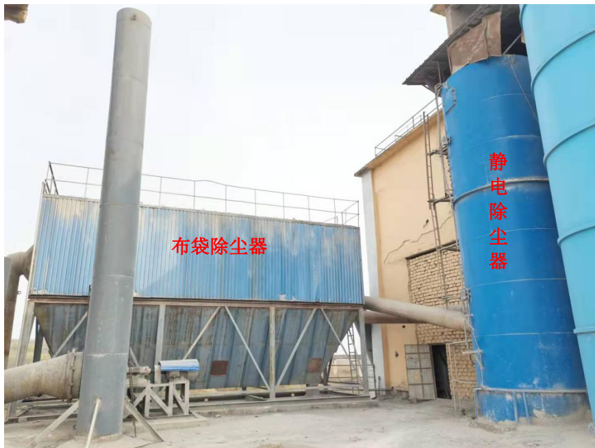
图 3-4 项目二期粉磨废气处理设施
