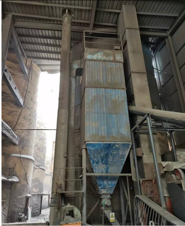
图 3-3 项目二期与一期进料、计量配料废气共用的布袋除尘器
