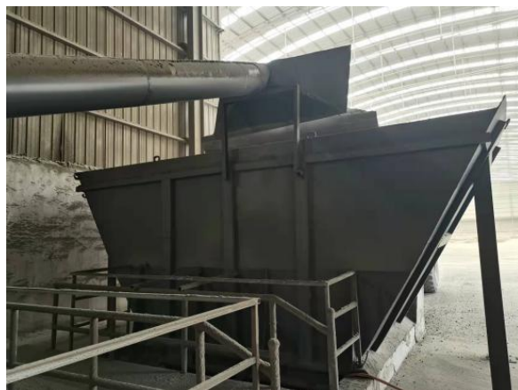
图3-2 项目二期新建的1处进料口
