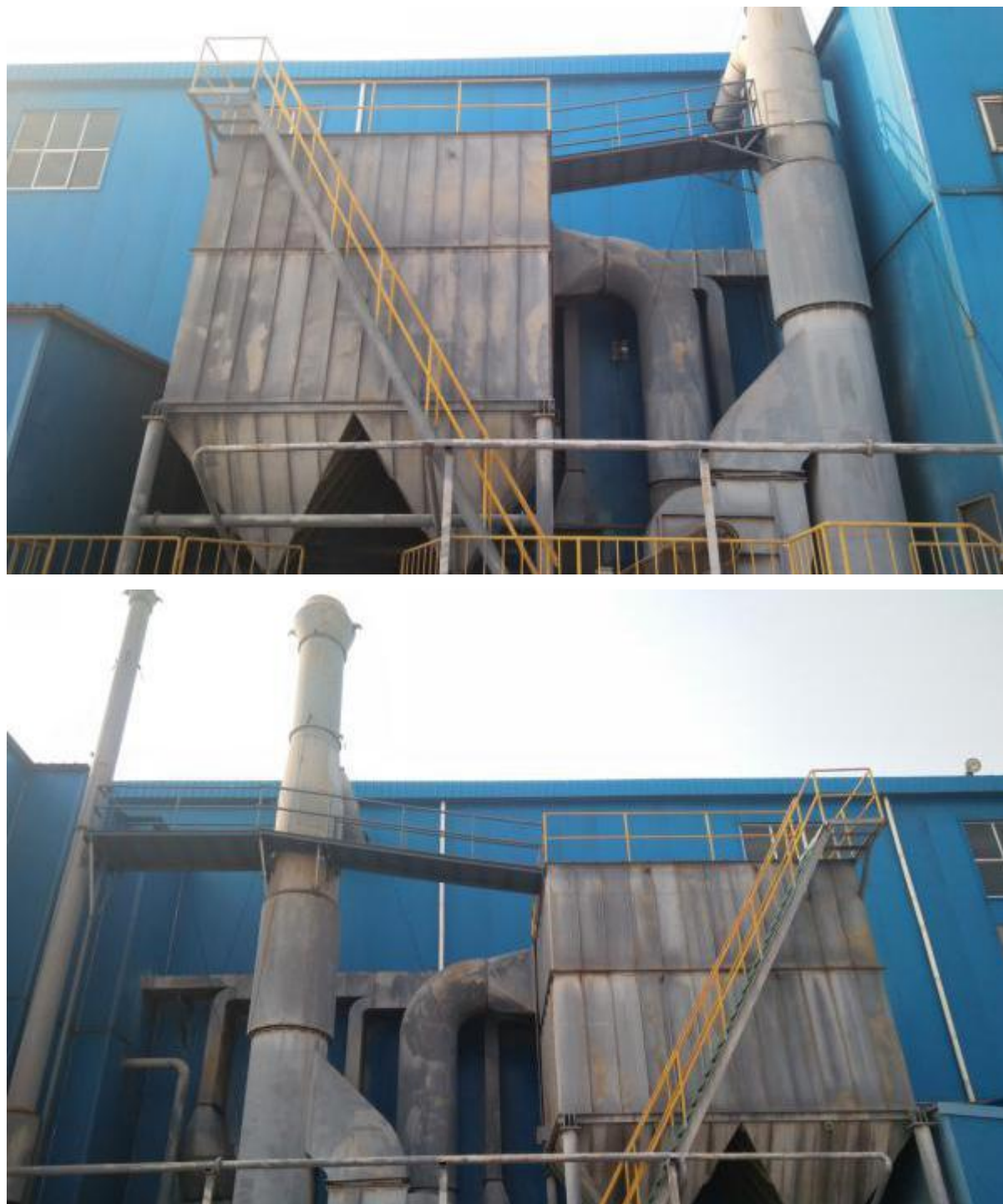
图3-3 喷砂废气布袋除尘器及排气筒
