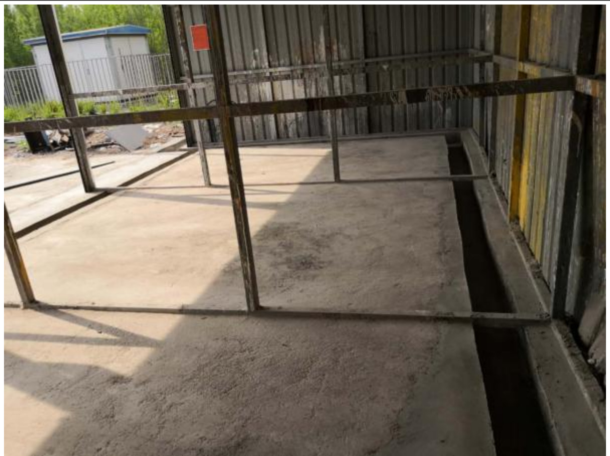
图3-5 危废间导流渠及收集池
