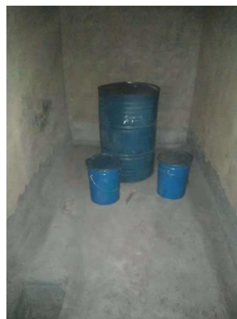
防锈桶、导流槽及收集池
