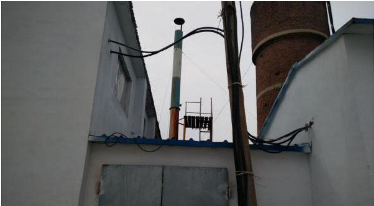
图 3-1 燃气锅炉排气筒
