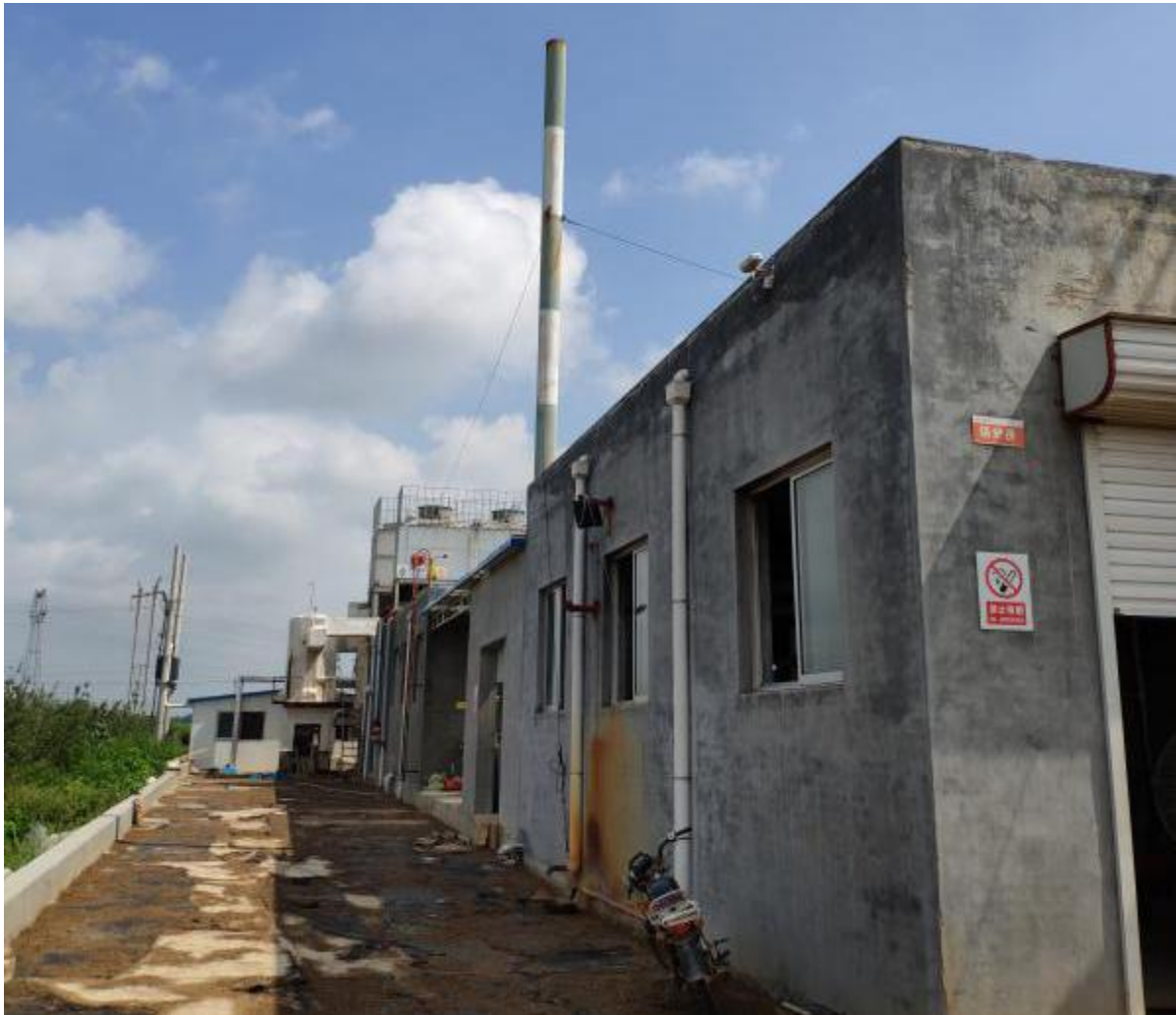
图 3-2 锅炉废气排气筒
