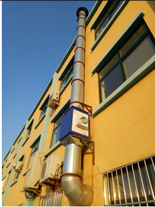
图 4-2 油烟净化器及排气筒
